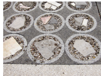
Tlak v Peklenskem dvorišču v Križankah kot primer recikliranja gradiva (foto Andrej Hrausky)
